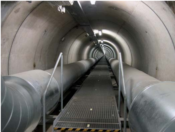
Abb. 3: Fernwärmeleitungen in einem Tunnel unter dem Rhein
