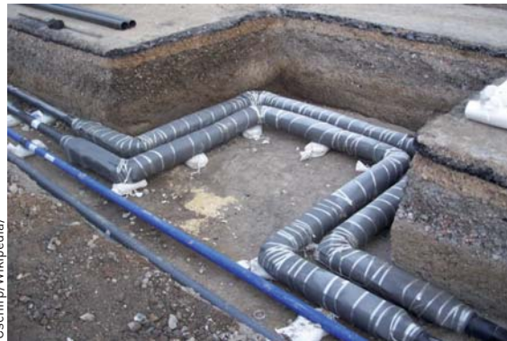
Abb. 2: Erdverlegte Fernwärmeleitungen mit Dehnungsbogen
